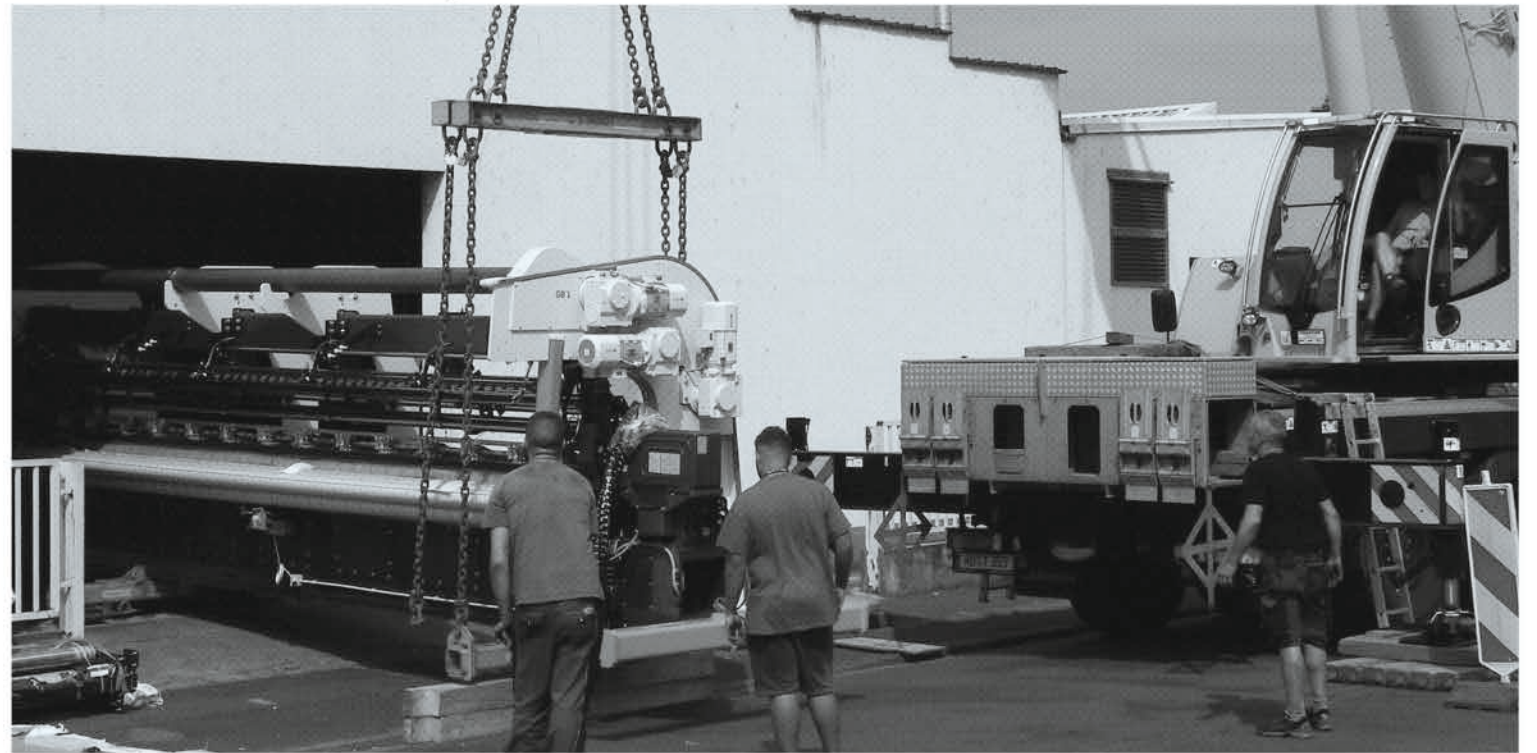
Vorsichtig hebt der Kran die schwere Maschine auf die Kanthölzer. Foto: Karl-Heinz Riedel
